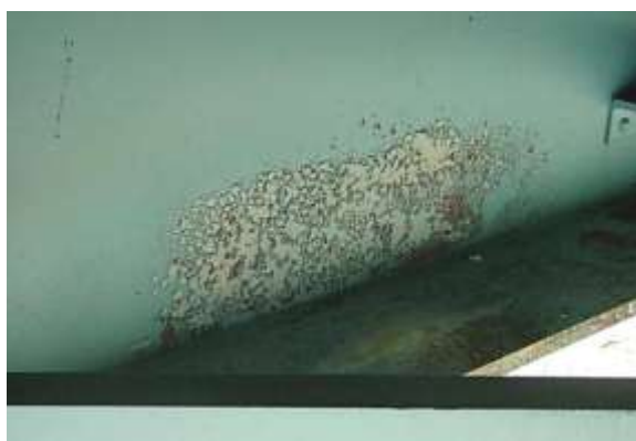
5.29-rasm. Oraliq qurilma to‘sinlarida bo‘yoqning ishqorlanishi va korroziyaning sodir bo‘lishi
