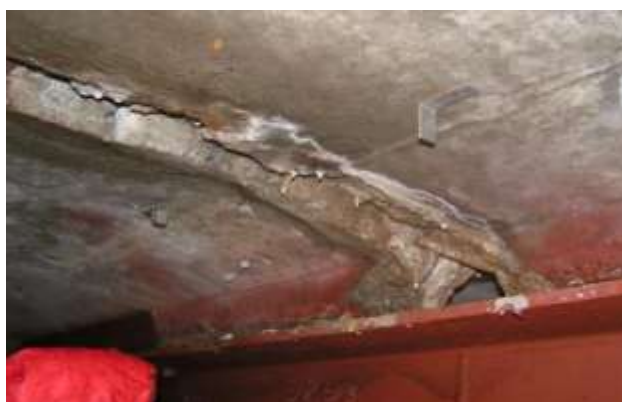
5.31-rasm. Gidroizolyasiyaning buzilishi va ballast koritasi plitasi tutashining uzilishi
