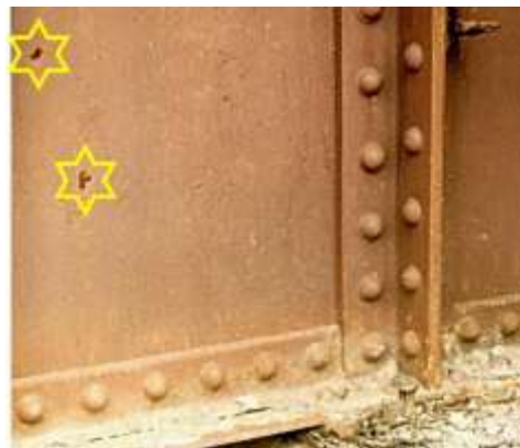
5.22-rasm. Lokal (ma'lum bir joy) (pitting) korroziya
