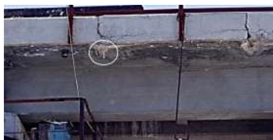
5.41-rasm 1.40. Stkalaktitli sumalaklar sobir boʻlishi tufayli betonning ishqorlanishi
