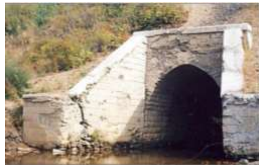
5.3-rasm. Quvur kallagining singan bo'laklari va qisman sinishi
