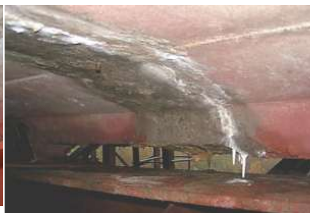
5.32-rasm. Ballast koritasi plitasi monolit tutash joyida yoriqlar sodir bo‘lishi va betonning ishqorlanishi
